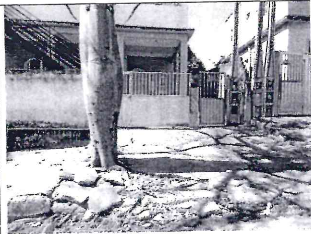
Figura 2 – Vista do local destacando-se a danificação expressiva da calçada e o bloqueio parcial da entrada de veículos.
