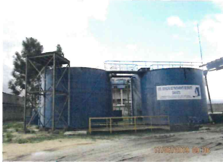
ETE Bairro Canivete
