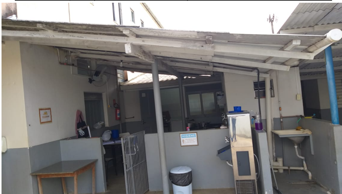
COZINHA PEQUENA, COM TELHADO BAIXO, OCASIONANDO CALOR EXCESSIVO:
