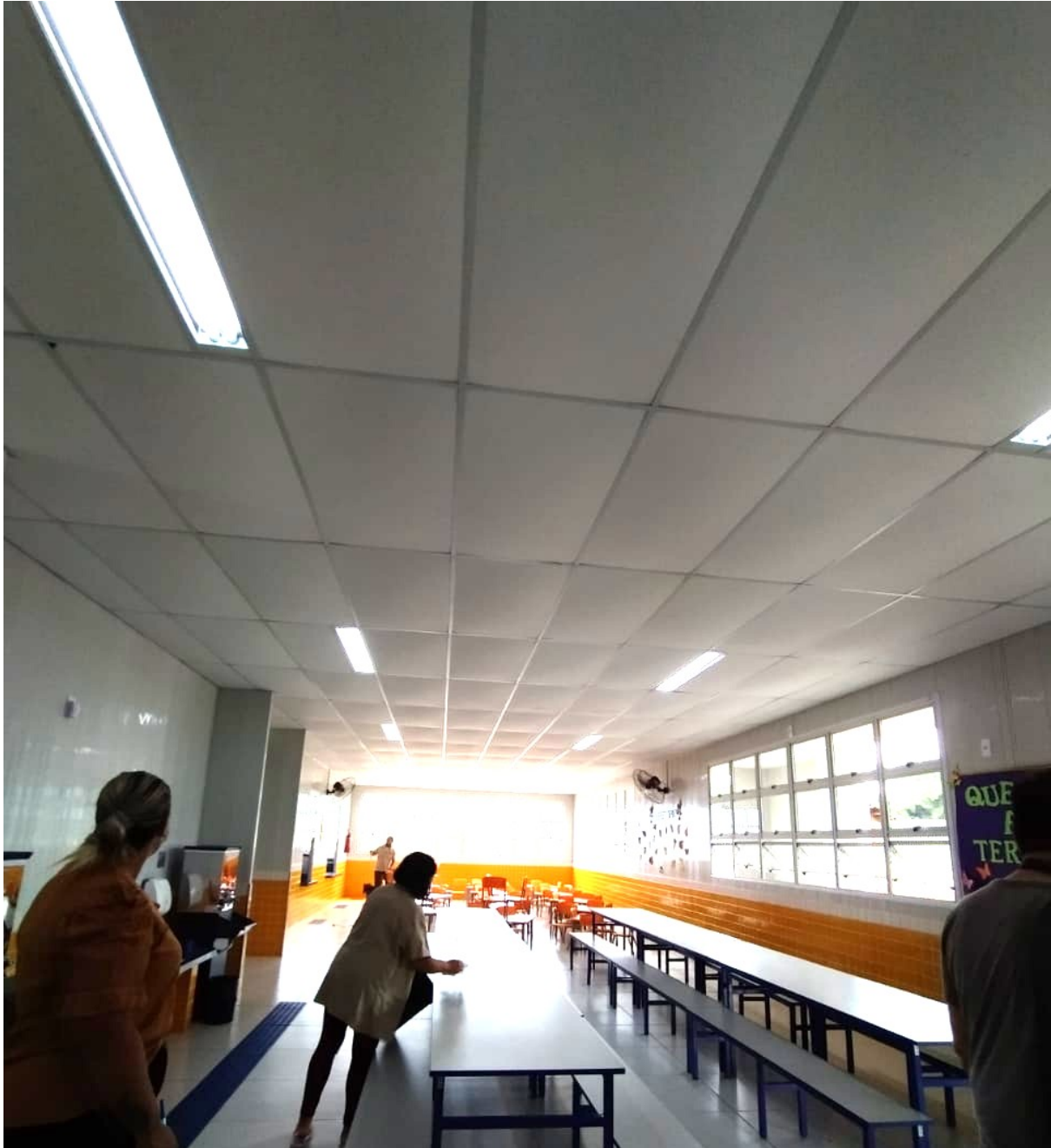
Refeitório, com apenas 2 ventiladores.
