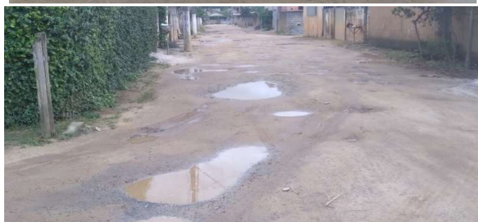
CRUZAMENTO ENTRE A AV. TOBIAS J.DE ANDRADE COM A RUA DOMINGOS BARBOSA, BAIRRO BEBEDOURO.
